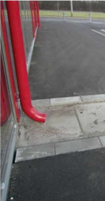
107 Ableitung der Dachabflüsse in Kastenrinne (oben links)
