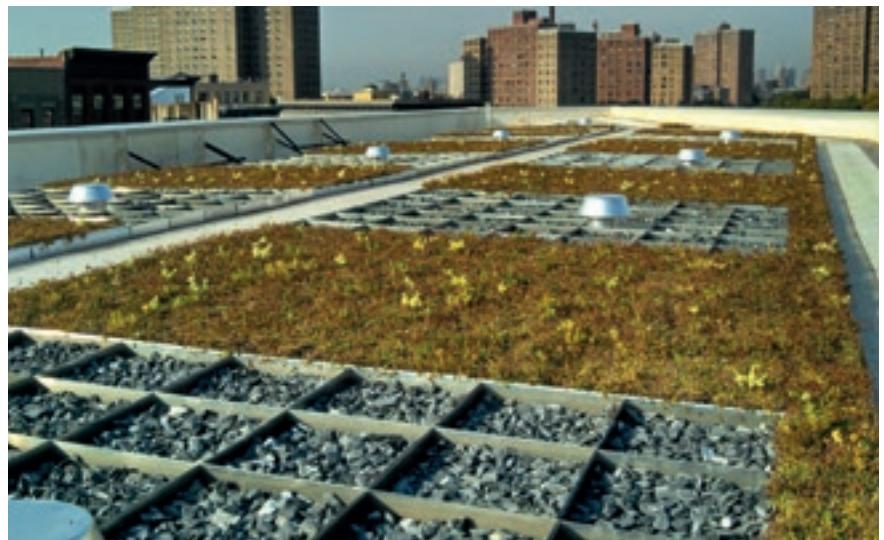
50 „Blaues Dach“ zum Rückhalt von Niederschlagsspitzen
