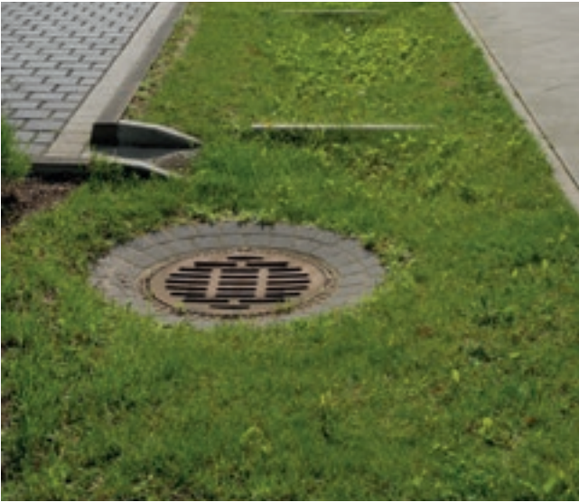
29 Dezentrale Straßenentwässerung über Muldenkaskaden
